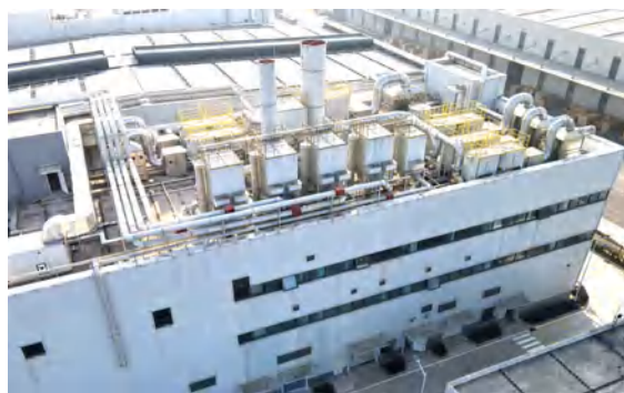
锦丰新厂废气处理装置
